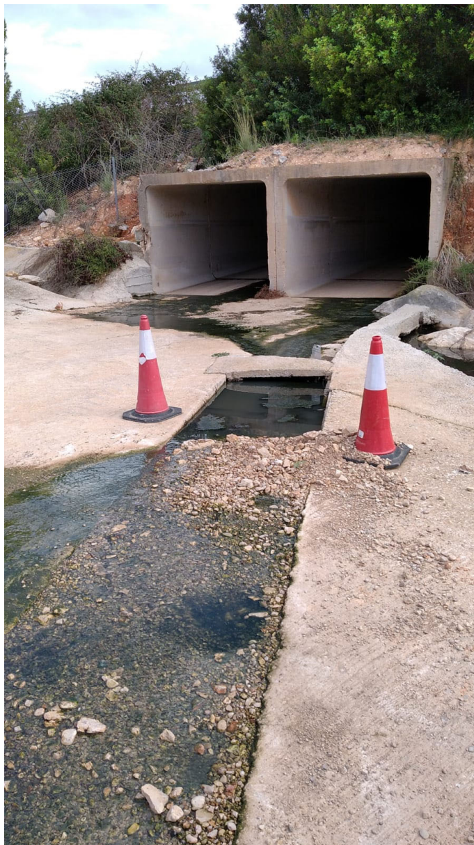
Pas de les aigües decantades per sota de l'autopista. Les reixes que protegien la rasa ha desaparegut.
