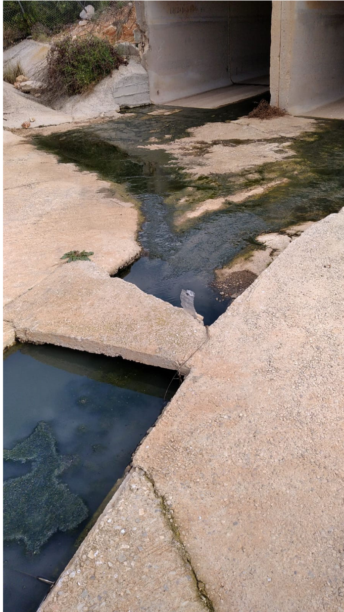
Vista de la rasa existent per al pas de les aigües decantades
