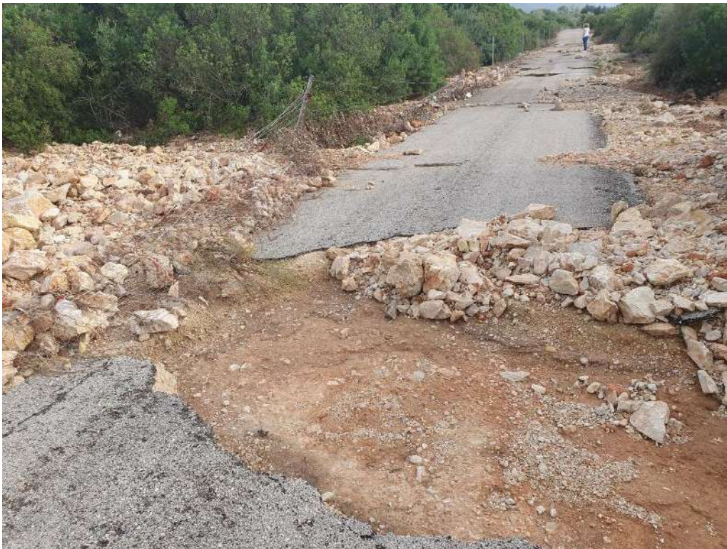
Vista general de camins després de la DANA
